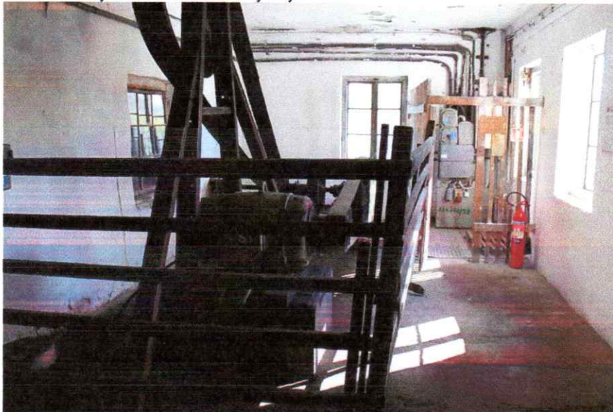
Ilustracja 29. Rozdzielnia elektryczna z silnikiem elektrycznym
